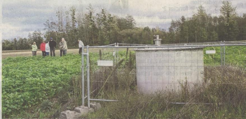
En amont du chantier du champ de captage, un puits « de reconnaissance » avait été creusé sur site il y a deux ans. PHOTO ARCHIVES DNA
